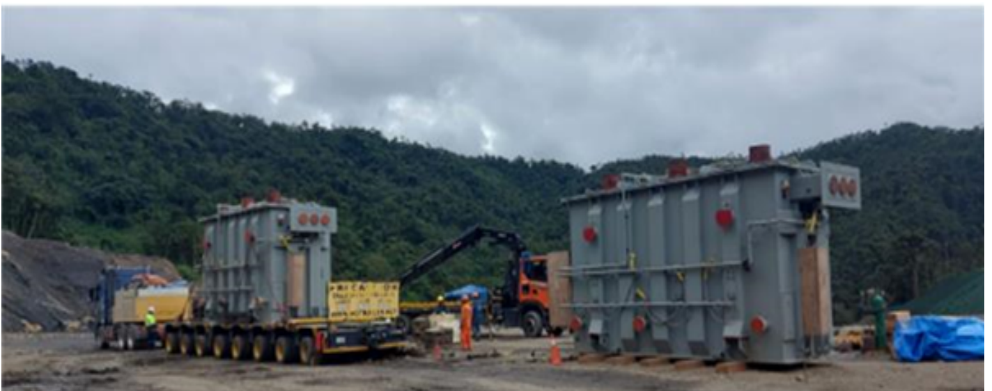
Transformadores de la Subestación Sehuencas
